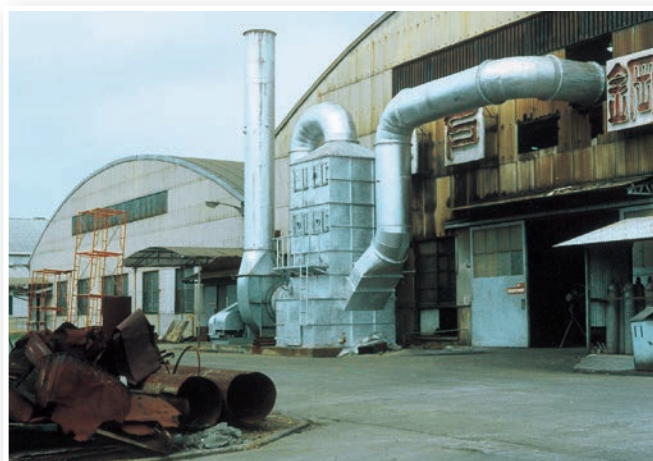
電気炉排ガス処理プラントを納入して公害防止に貢献する。
