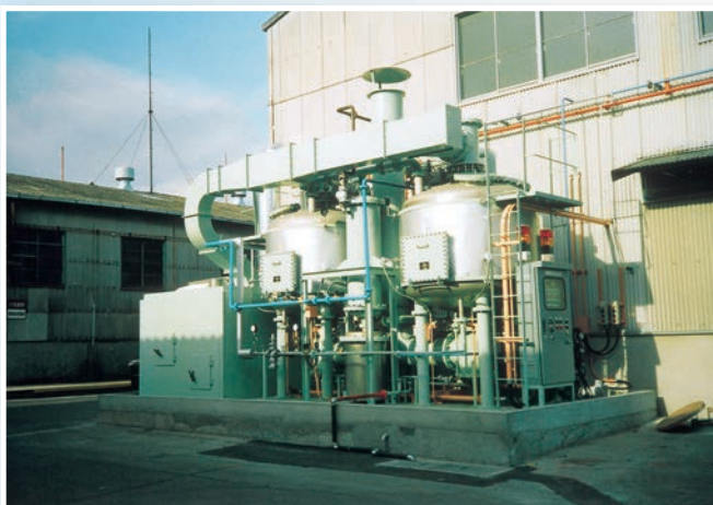
塗料製造工場における、炭化水素類の排ガス処理と 溶剤回収の設備を納入し好評を得る。
