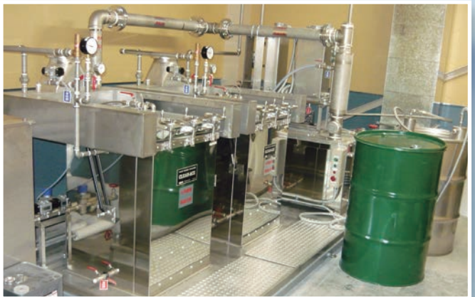
日本トップクラスの企業の塗装現場に装置を納品。ドラム缶からの自動処理で1日あたり300Lの廃シンナーを社内リサイクル。
